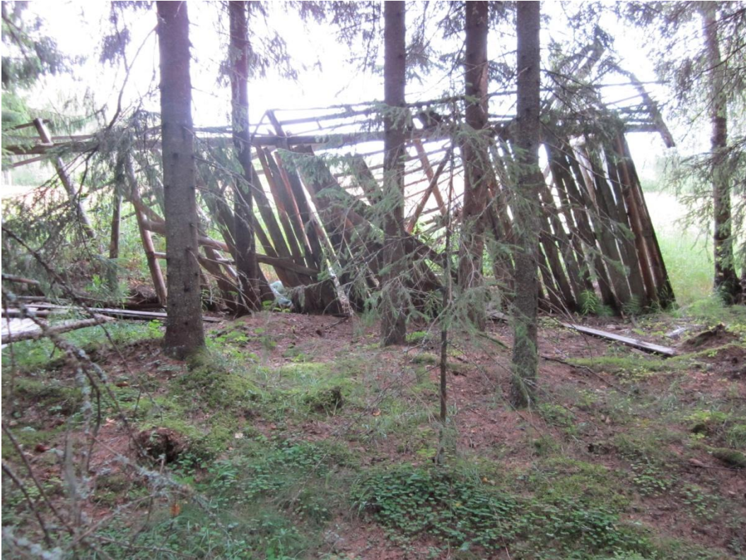
Kuva 3. Vanhanmajankankaan reunassa oleva osin romahtanut vanha rakennus.
